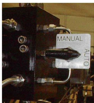
Figura 4: Válvula de desvio hidráulico
